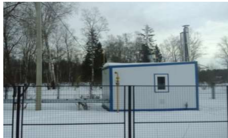
Теплогенераторная установка школы в п. Восток
